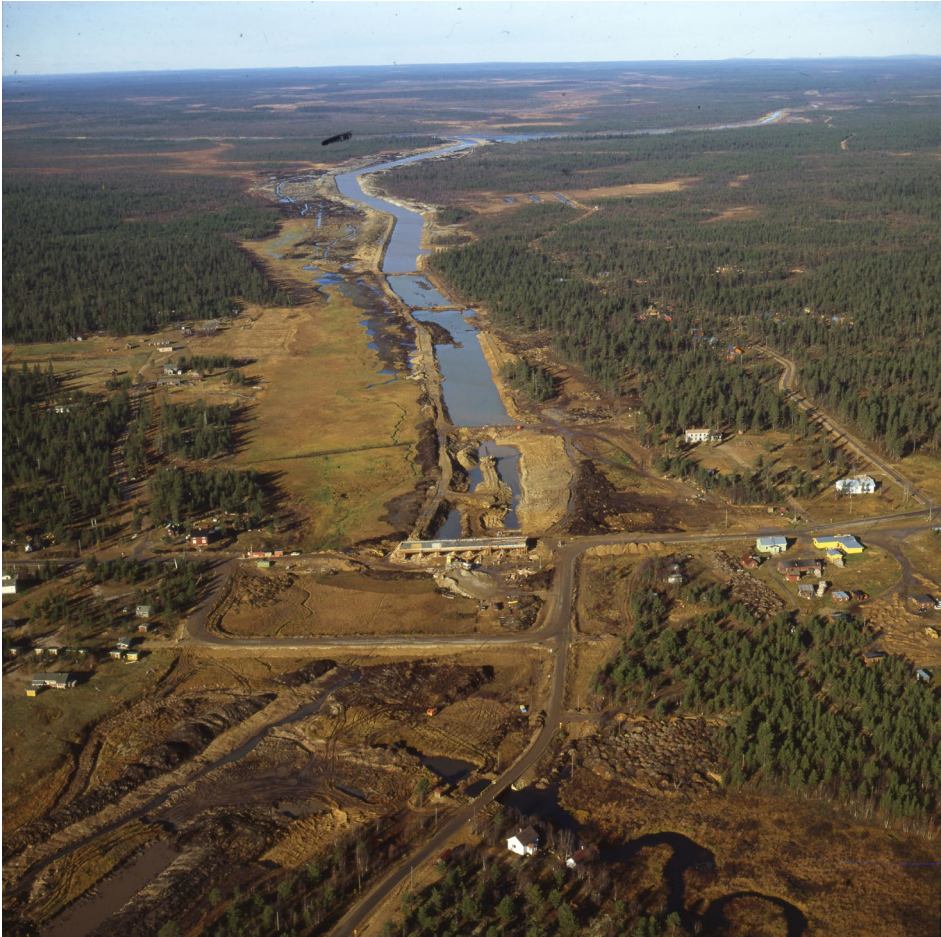
Kuva 007. Vuotson kanava rakenteilla vuonna 1980. Kiistely Lokan ja Porttipahdan eduista ja haitoista jatkui. Perinteiset mekaaniset vetokaivukoneet eivät olleet enää kilpailukykyisiä maapohjan heikon kantavuuden takia. Kanavalla siirrettiin maita noin 3 milj. m 3 , josta neljännes imuruoppauksella ja loput hydraulisilla kaivukoneilla ja traktoridumppereilla. Vuotson kanavan muistomerkin paljastustilaisuus ja kanavajuhla järjestettiin 7.10.1981. Muistomerkin kivipaasi tuotiin läheisestä Riestovaarasta. Porttipahdan rakentajien muistomerkki on Porttipahdan padolla. Valokuva ELKA. Kemijoki Oy. 11742.
