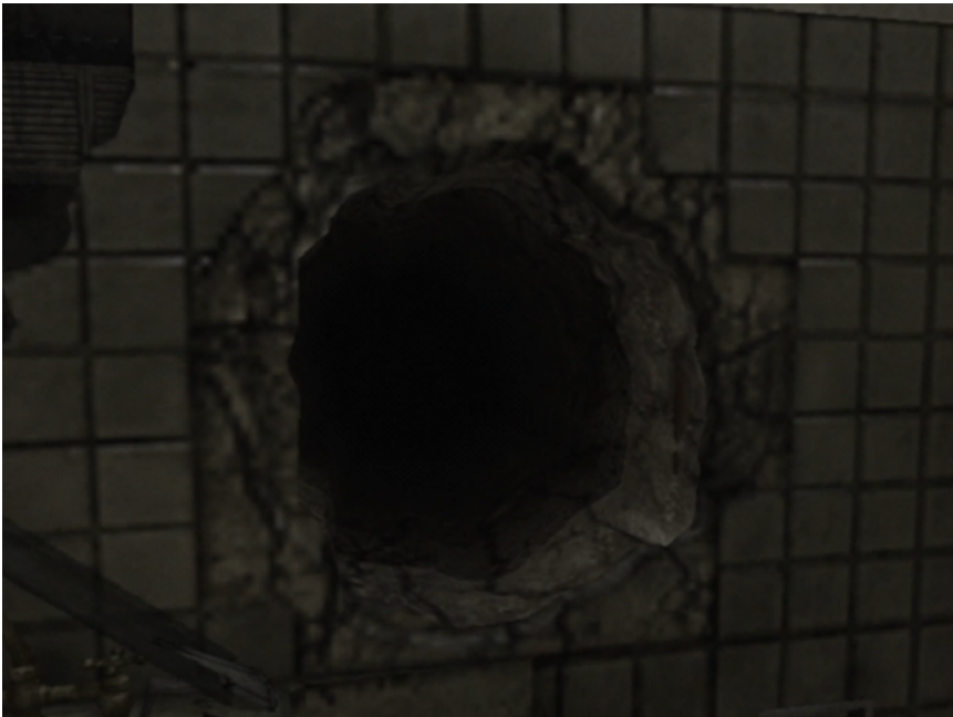
Kuva 2: Reikä Henryn asunnon kylpyhuoneessa. Ruutukaappaus.
